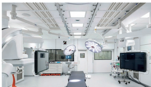
Rys. 4. Szyny ramienia C angiografu w centralnej części sufitu sali – jedna z podstawowych kolizji technologii medycznej z klasyczną wentylacją sali operacyjnej
