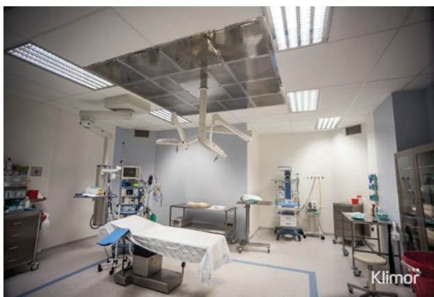
Rys. 2. Zdjęcie sali operacyjnej po realizacji (źródło: Klimor Sp. z o.o.) Fig. 2. Photo of the operating room after implementation (source: Klimor Sp. z o.o.)
